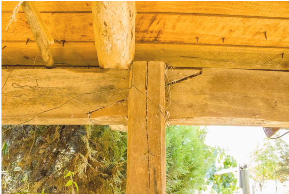
C2F8 DETALLE Unión de vigas maestras en Z sobre pilar del corredor.
