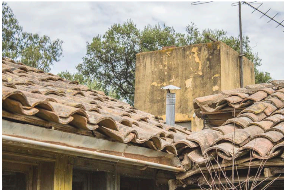
C3F6 DETALLE Encuentro de techumbres de los diferentes volúmenes que componen la U.
