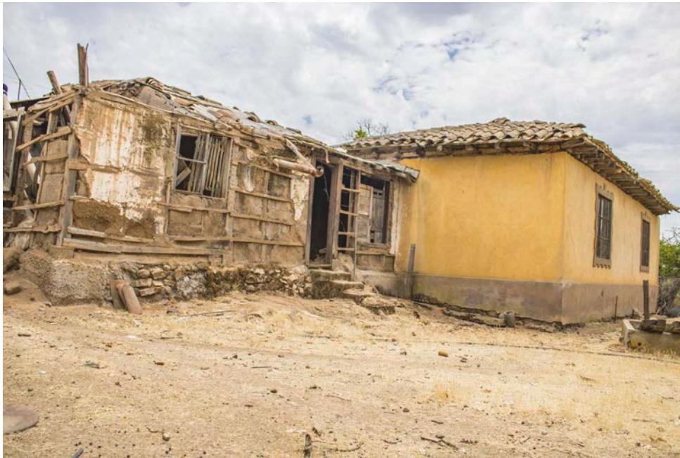
C3F12 FACHADA SURESTE Diferencia en el estado de conservación de los volúmenes producto de la ausencia de cubierta.
