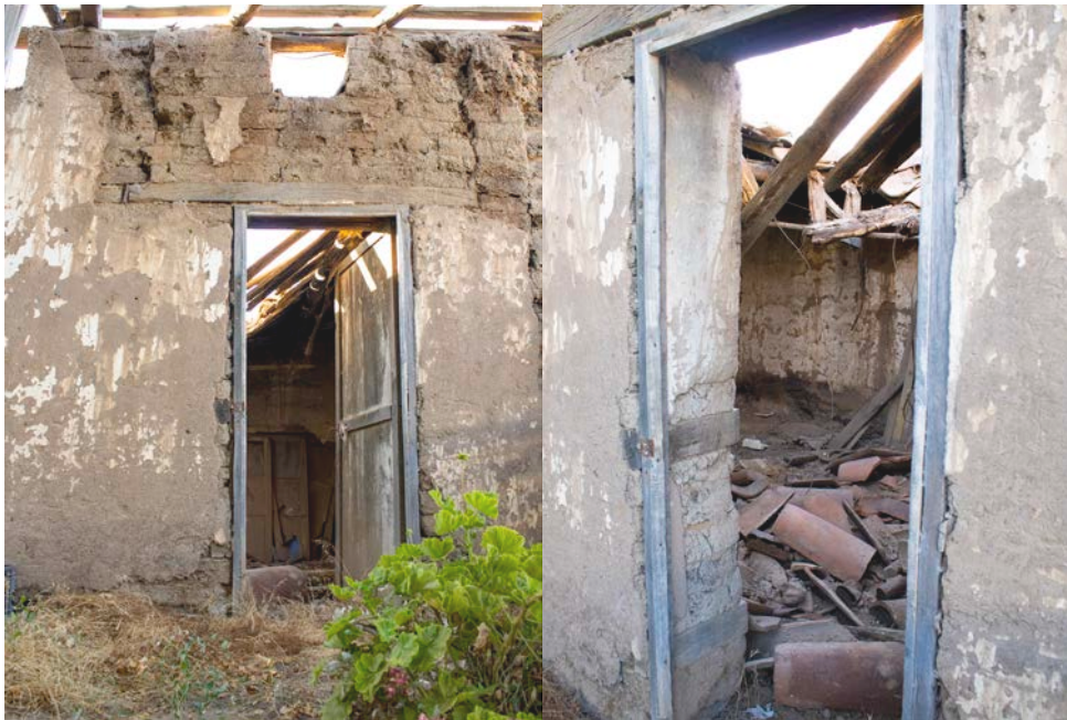
CF14 DINTEL Dintel de madera sobre vano de puerta de la cocina exterior en casa Silva Silva.
