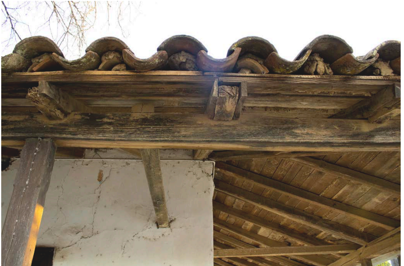
CF13 TECHO CORREDOR Estructura compuesta por pilares, soleras y vigas en corredor. Sobre esta estructura descansa un entablado que recibe las tejas. Corredor de la casa Cornejo Rojas.
