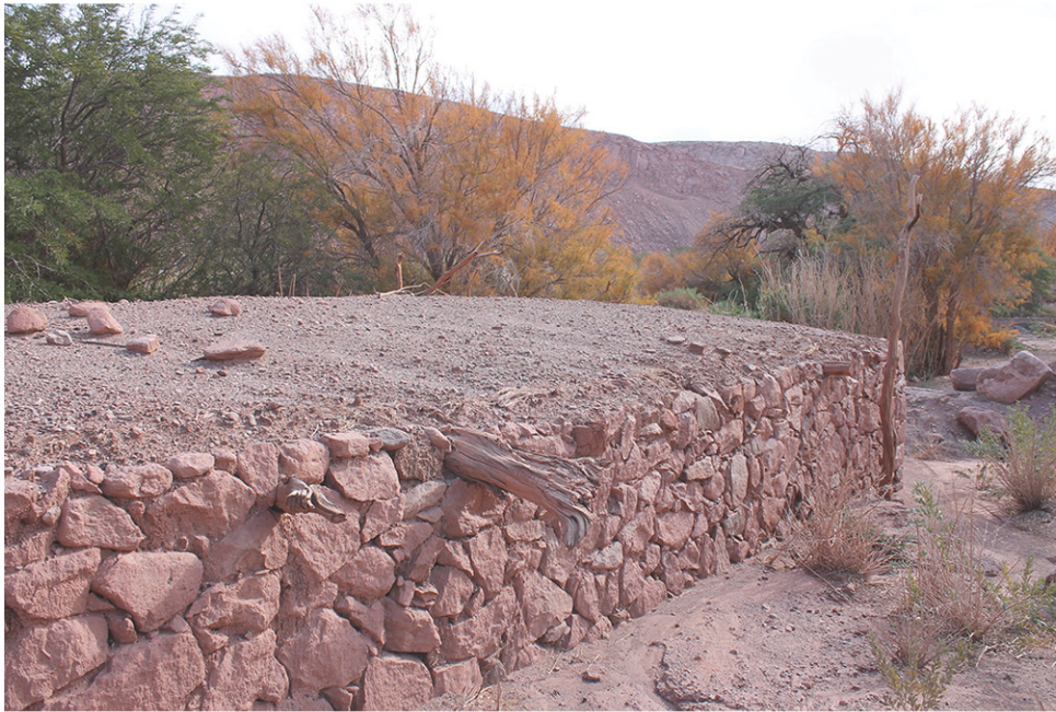
C5F8 ESPACIO RELEVANTE Muro oriente compuesto de mampostería de piedra, con una altura de 1.2 m hundida bajo tierra por acumulación de barro.
