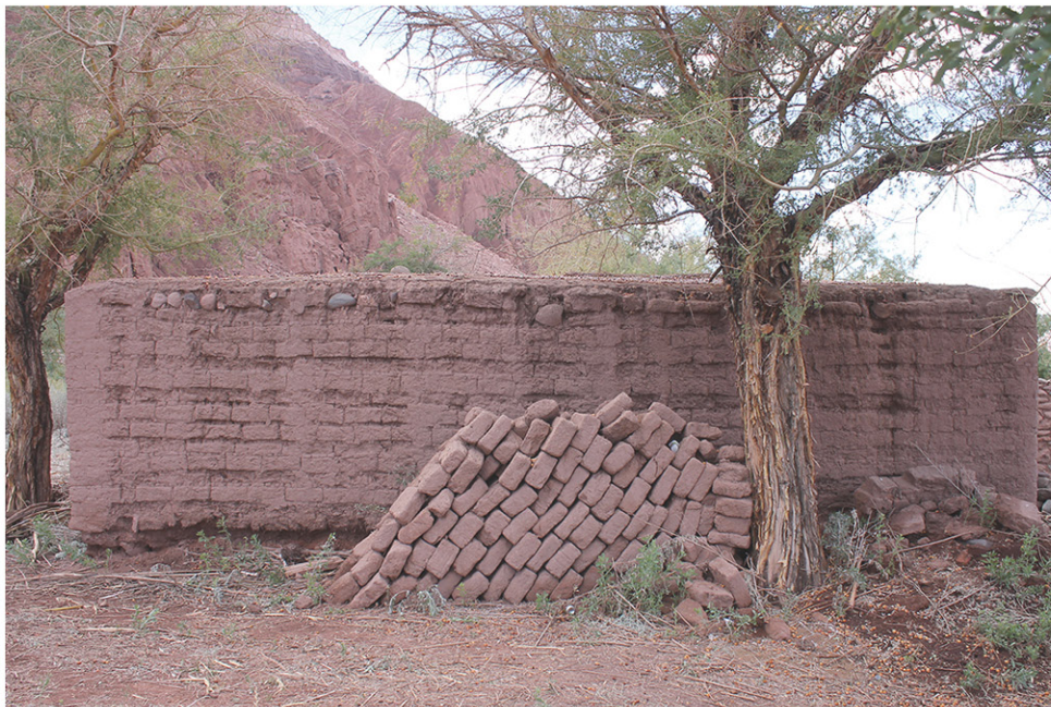
C4F9 ESPACIO RELEVANTE Muro poniente de la vivienda. Presencia de cemento erosionado piedras en el canto superior del muro.
