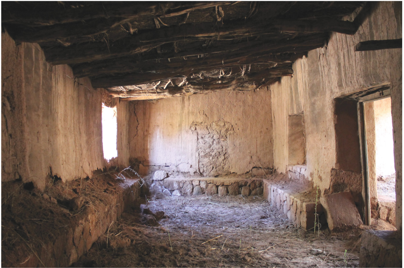
C1F5 ESPACIO RELEVANTE Salón principal donde se realizaban almuerzos y acontecimientos familiares. Presencia de poyo de piedra en todo el perímetro. Paredes interiores revocadas en barro.
