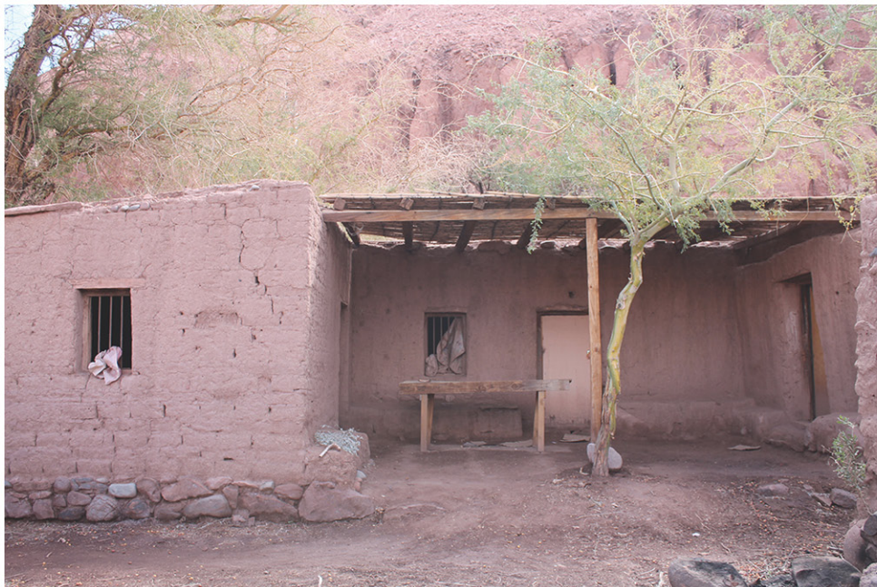
C4F2 FACHADA PRINCIPAL Vivienda tradicional de tipología "U", la más común entre las casas atacameñas. La concavidad de la "U" genera un espacio convergente de estar, el cual articula tres volúmenes construidos correspondientes a habitaciones y sala común.
