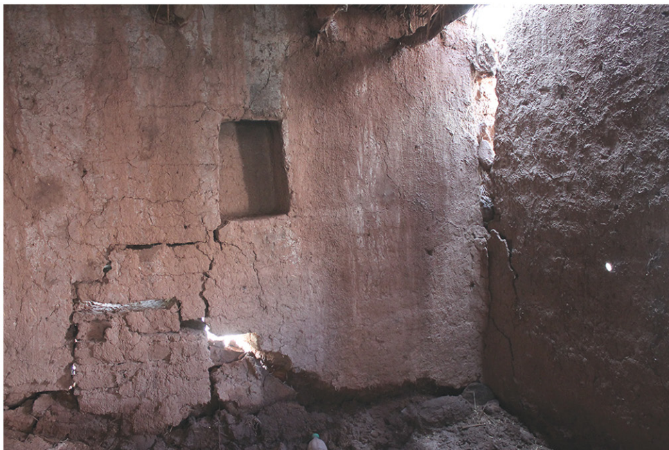
C4F3 DETALLE Mueble en obra para poner velas. Se observan de fallas estructurales en muros de adobe.
