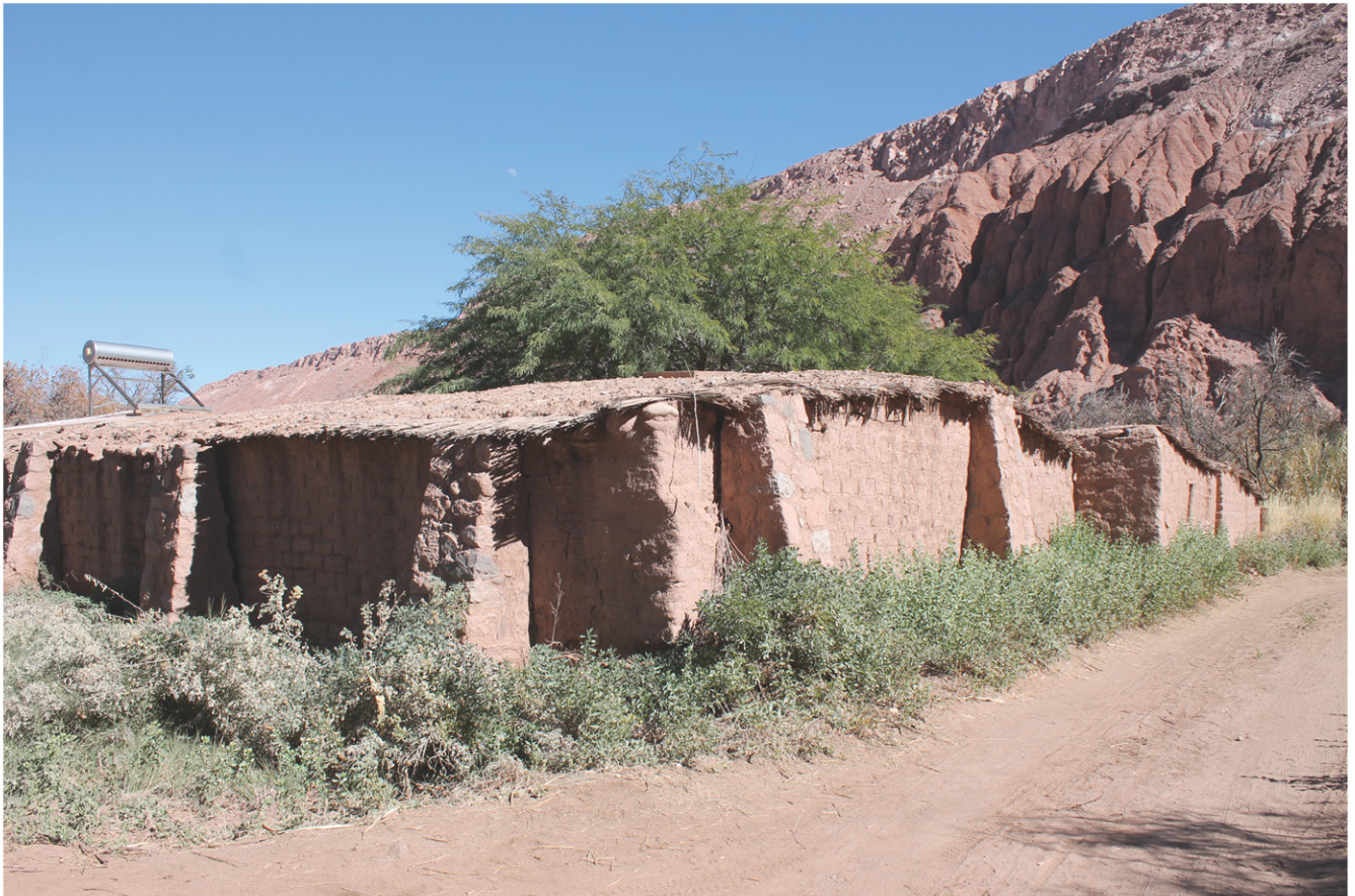
C1F11 ESPACIO RELEVANTE Vista perimetral de la vivienda. Presencia de contrafuertes sin traba al muro.
